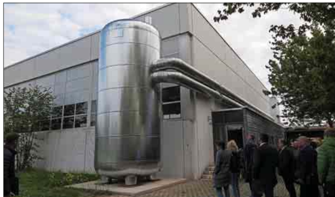
Der neue Pufferspeicher an der Nordseite der Werkrealschule fasst 30.000 Liter Wasser
