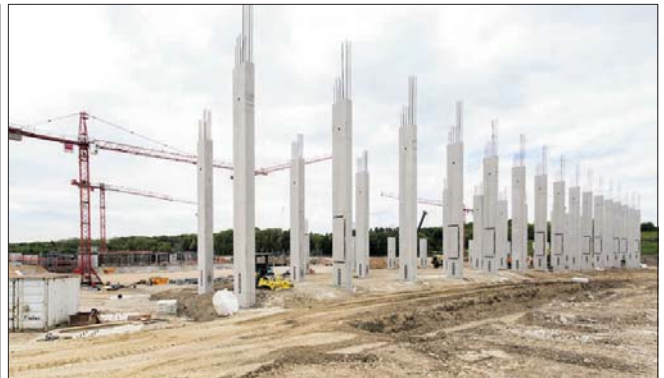
Erste Konturen sind bereits erkennbar: Das neue Stadion am Flugplatz wächst rasch, und ein Baustopp ist juristisch abgewendet. (Foto: A. J. Schmidt)
