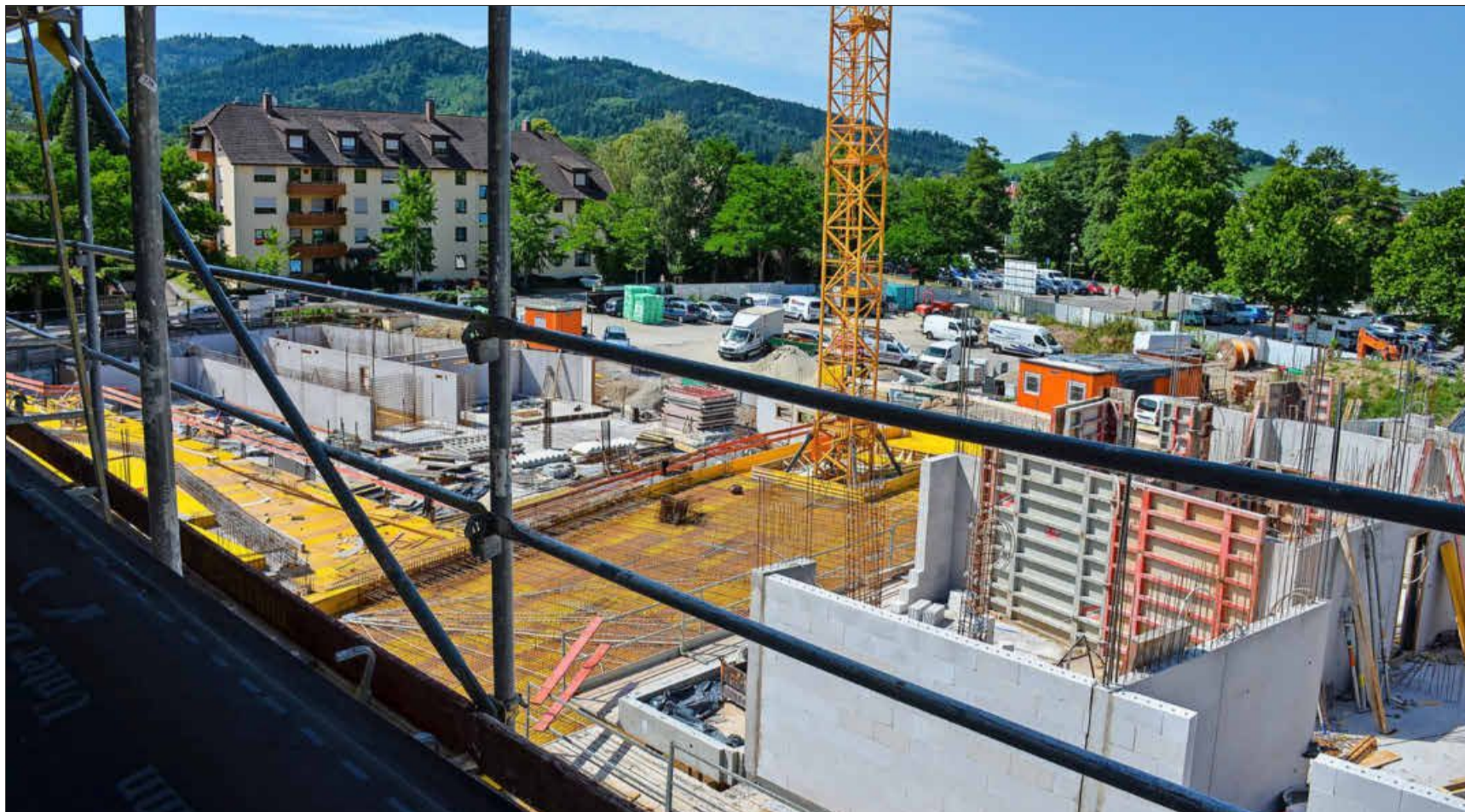
Die Bebauung des Schladerer-Areals in Staufen nimmt Gestalt an: Drei von sechs Rohbauten stehen, bei den drei anderen haben die Arbeiten begonnen.
